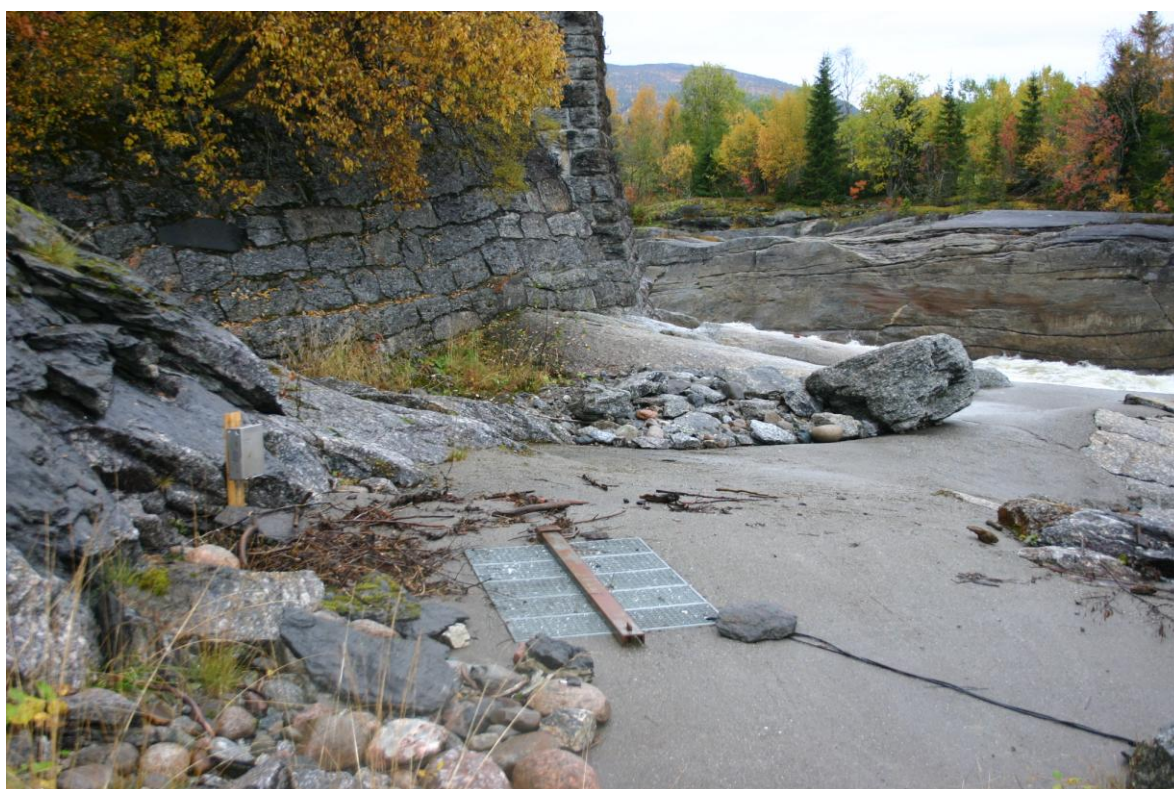
Figur 2. Fisketrappa er sprengt ut i fjell og går stedvis lukket. Inspeksjonsluka på bildet viser hvor i fisketrappa i Tømmeråsfossen fisketelleren er plassert.
